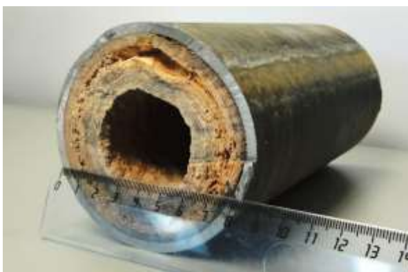
Рис. Накипь на стенках трубы отопления
