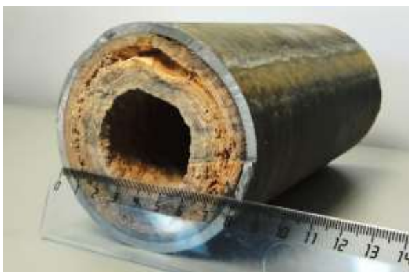
Рис. Накипь на стенках трубы отопления
